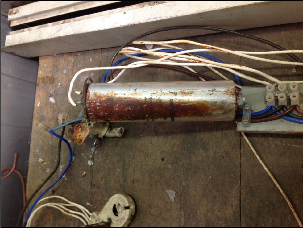
Kondensatorerne kan ved tæring blive utætte, så PCB lækker fra kondensatoren.
